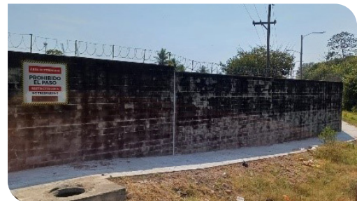
Muro perimetral de concreto y caminamiento en la parte externa e interna
